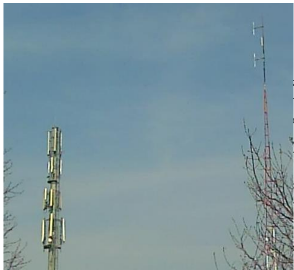
Communicatiemast A – Baarle Nassau
