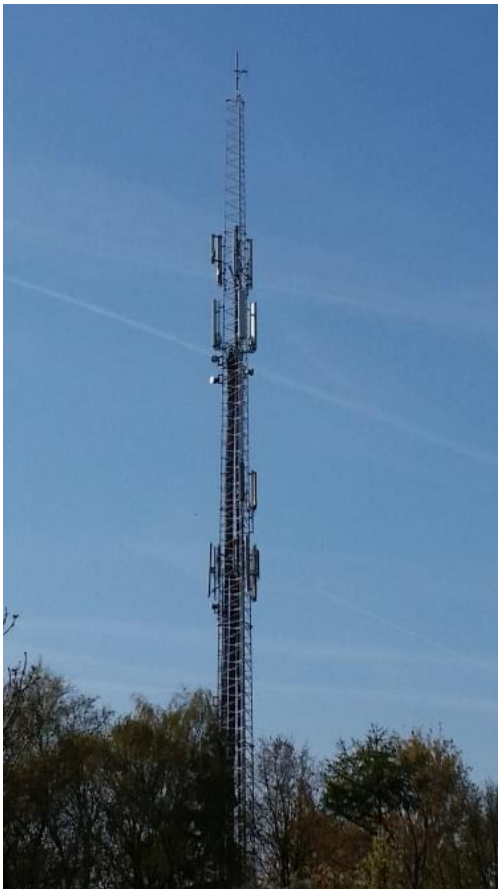
Foto 1: Antenne mast Oude dijk.
