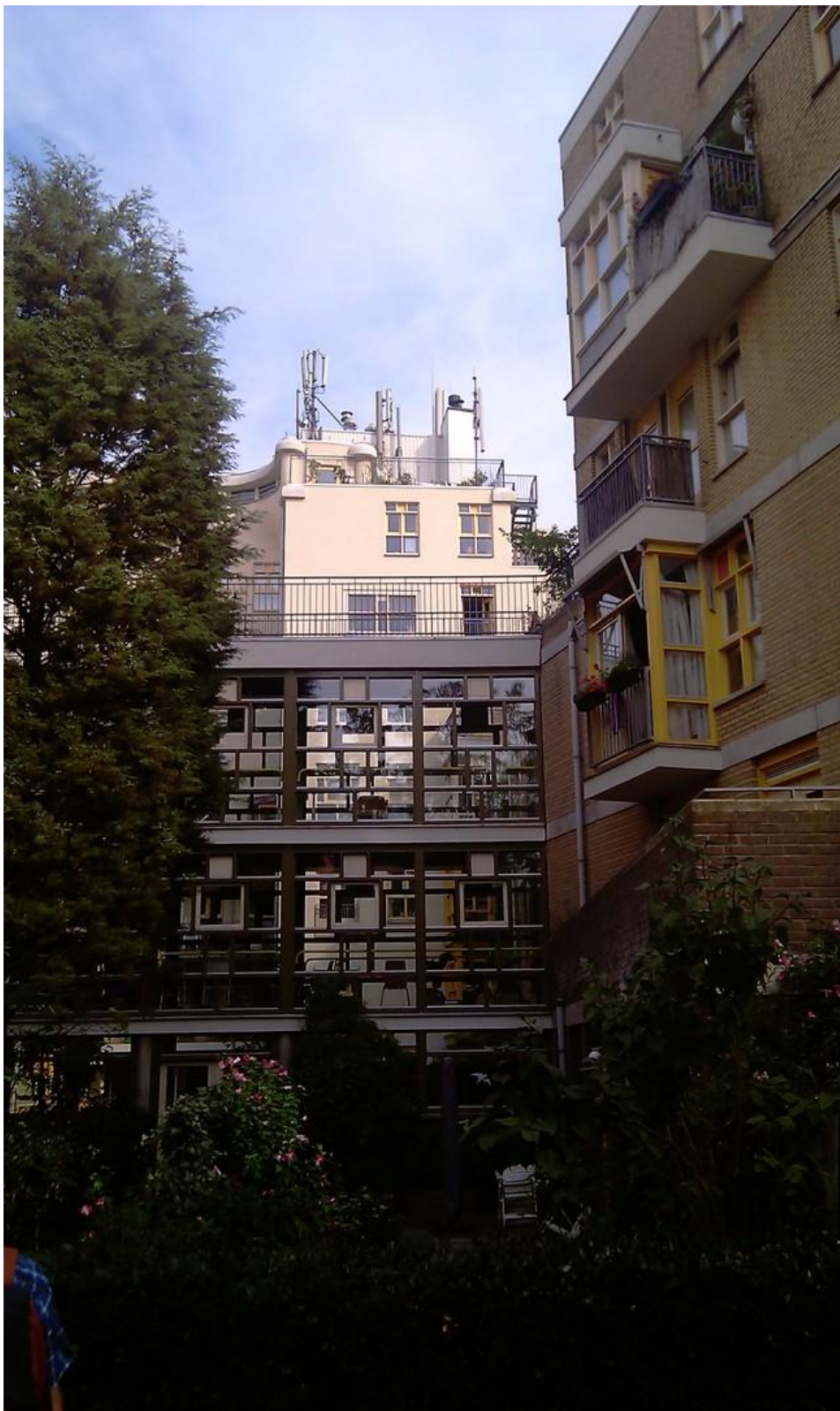
Foto 6; Antenneopstelling van de GSM en UMTS antennes van de operators KPN, Vodafone en T-mobile op het dak van verzorgingshuis Flesseman.
